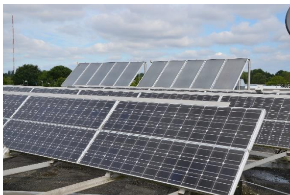
Abbildung 19: Solarthermie auf dem Betriebsgebäude
